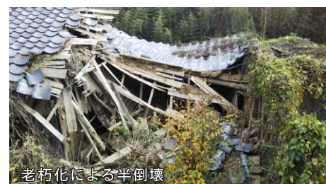
老朽化による半倒壊
